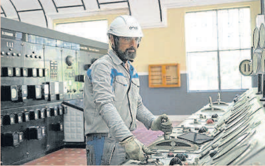
Un operario en los antiguos mandos de la central de Seira
